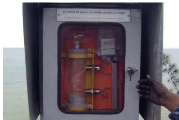
Painel com Reservatório: 2 Sensores com Alarme e Trip
